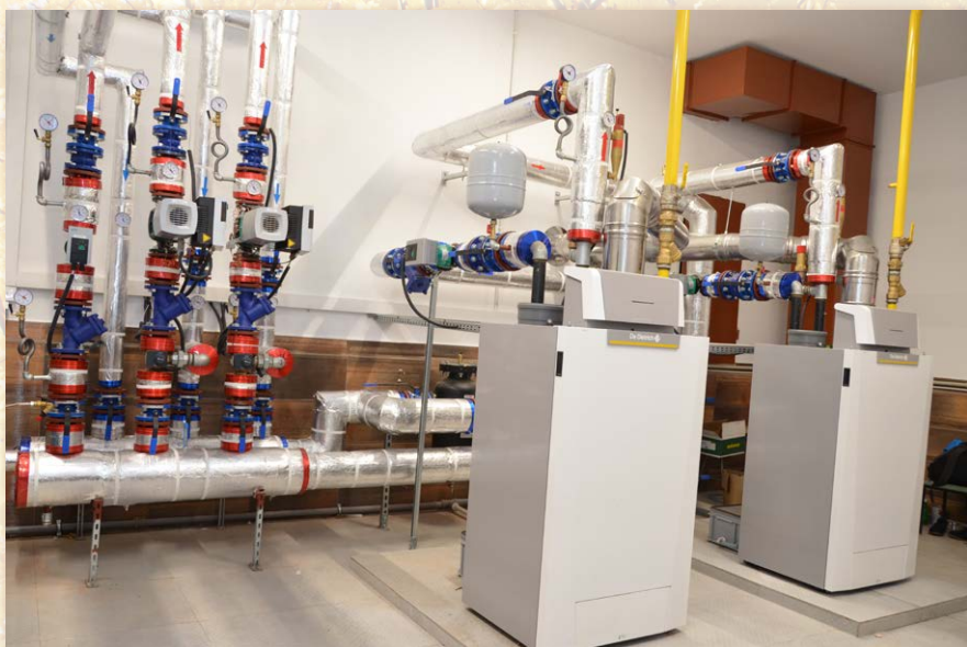
Kotłownia w I Liceum Ogólnokształcącym
