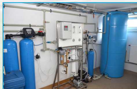
Stacja uzdatniania wody na potrzeby sterylizacji
