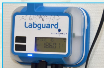
system monitoringu temperatury i wilgotności powietrza
