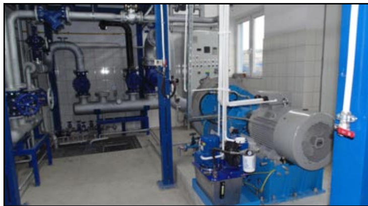
Turbogenerator parowy do wytwarzania energii elektrycznej
