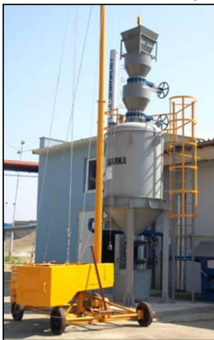
Zgazowarka wytwarzająca gaz do opalania kotła parowego
