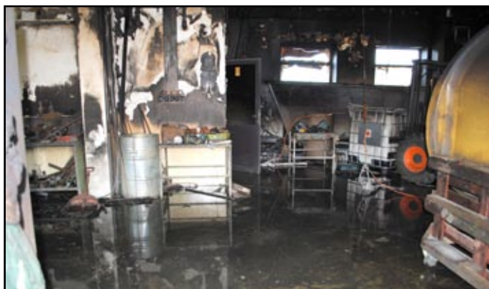
Pożar hali produkcyjnej w Haczowie
