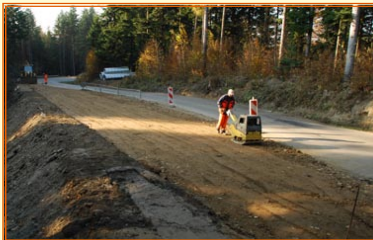
... na drodze powiatowej Brzozów-Wara w miejscowości Przysietnica
