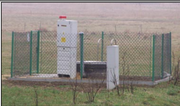
Przepompownia ścieków we Wzdowie
