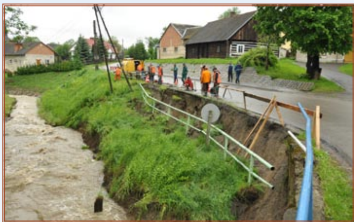
Uszkodzony podczas powodzi most w Jablonicy Polskiej
