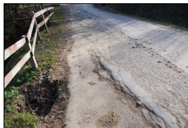
Zniszczona droga Dydnia-Krzywe-Końskie
