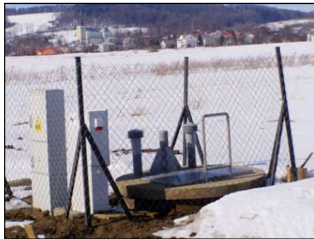
Przepompownia ścieków w Jasionowie
