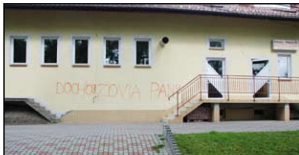
Zniszczona przez graficiarzy elewacja piekarni
