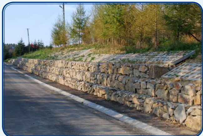
Zabezpieczone osuwiska na drodze Izdebki Obarzym (w Obarzymie)...
