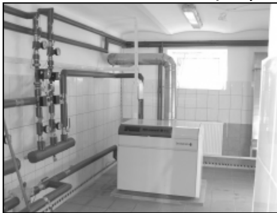
Nowa kotłownia gazowa
