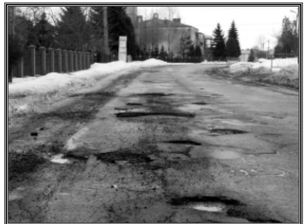
Odcinek drogi Iskrzynia - Trześniów przed remontem ...
