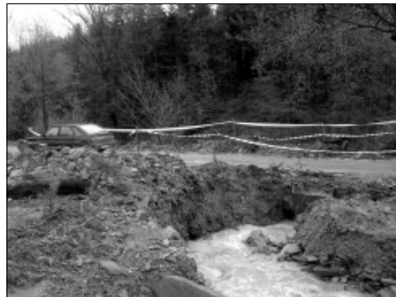
Osuwiska na drodze powiatowej w Warze
