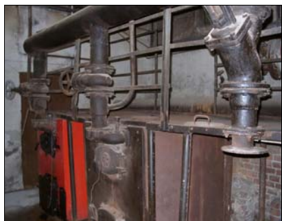
Węglowa kotłownia w Internacie ZSB w Brzozowie przed modernizacją
