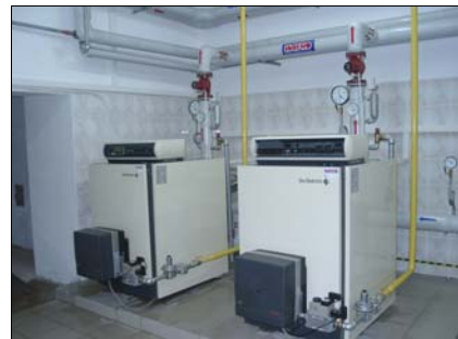
Nowa kotłownia gazowa
